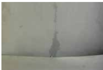
Poškození stěn v interiéru po vniknutí vody
